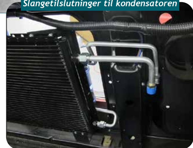
Slangetilslutninger til kondensatoren
